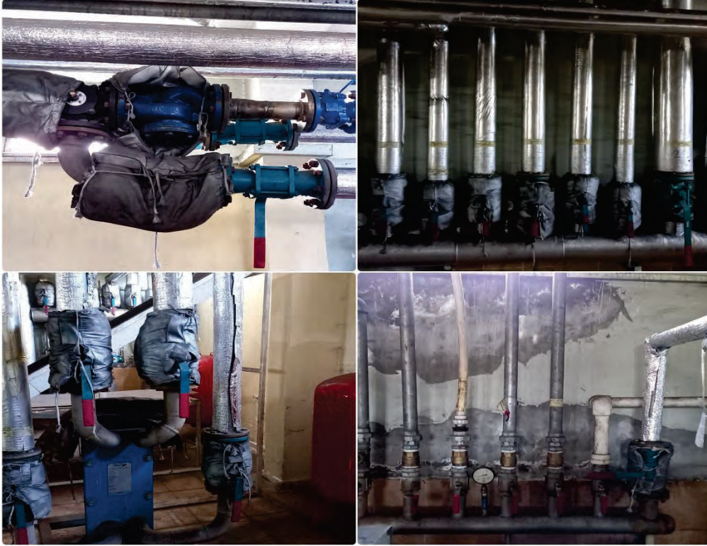
Şekil 13: Isıtma Mekanik Tesisatı Görüntüleri
