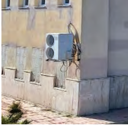
Şekil 9: Split Klima Dış Ünite Görüntüsü
